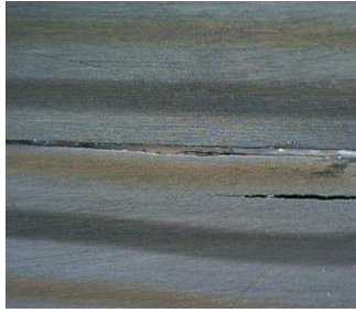
Abb.1 Rissbildung innerhalb Ag935 Lage
